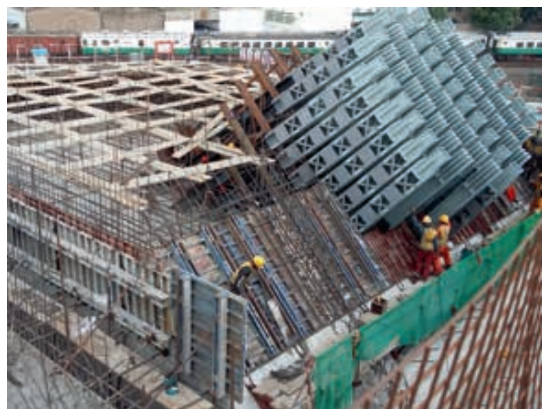
Einbau der Stahlteile aus China für die Hauptseilverankerungen auf der nördlichen Seite.
